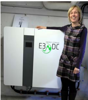
Mit dem Storage S10 ist eigenes Strommanagement einfach möglich
